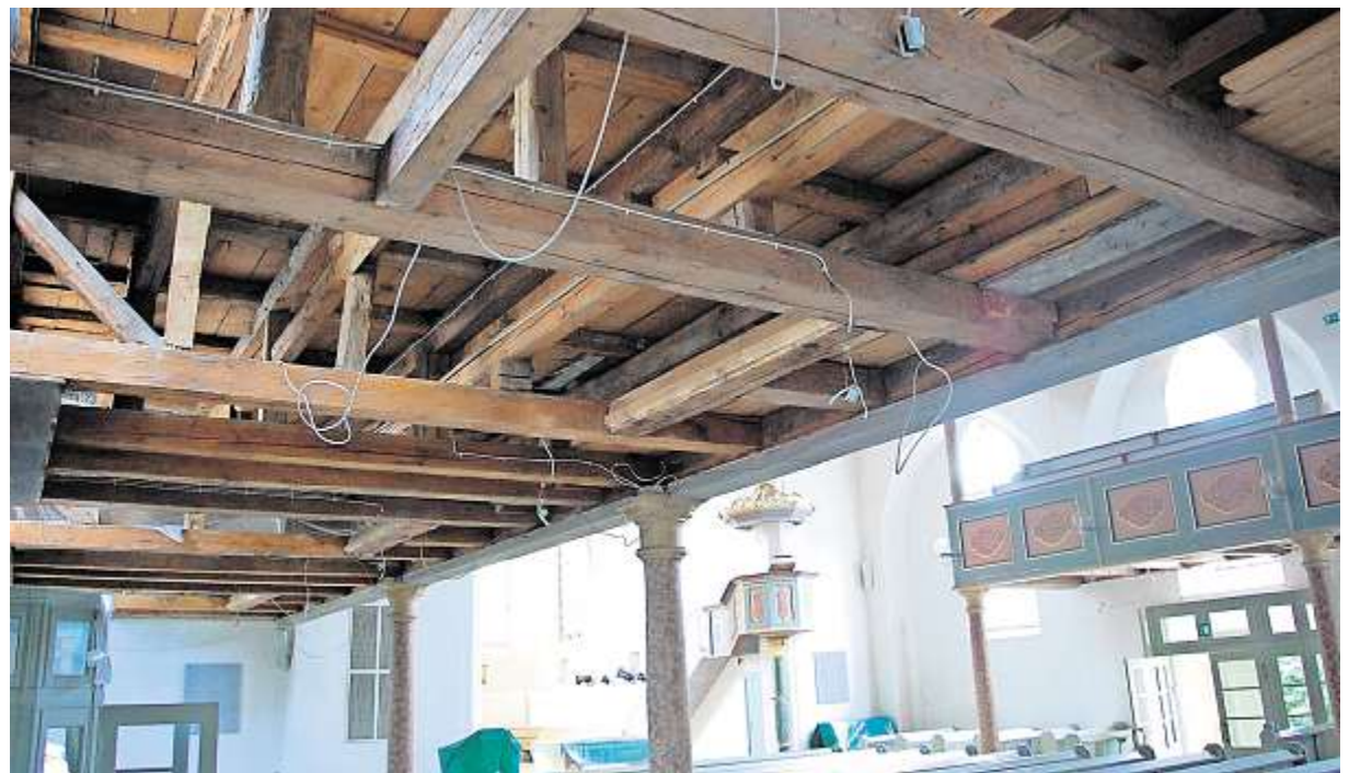
Ein Blick an die Unterseite der Empore eröffnet die wirre Konstruktion, die schon bald erneuert sein wird.
